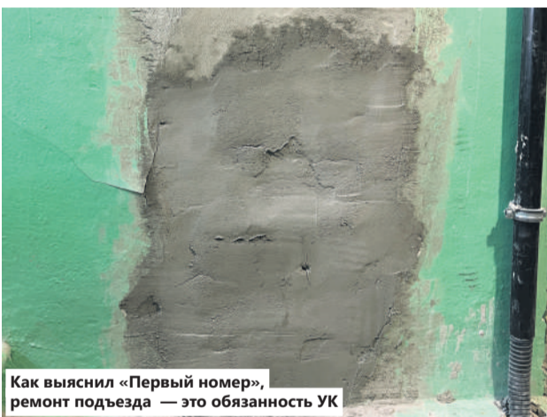
Жители сетуют, что до сих пор не сделан ремонт в подъезде, хотя окна и входную дверь ФКР поменял
